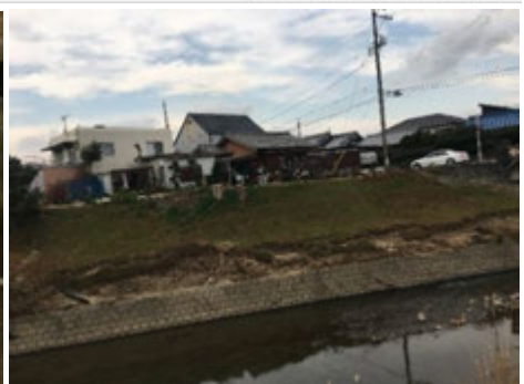
氾濫により崩れてしまった河川敷
