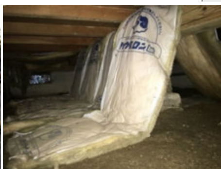
水を含んだ断熱材が剥がれ落ちている様子
